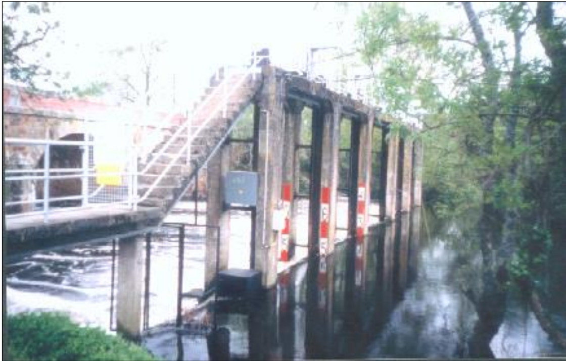
Photo : vannage de Bouaye
